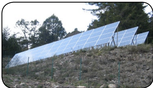
Panneaux photovoltaïques à Aire-de-Côte
